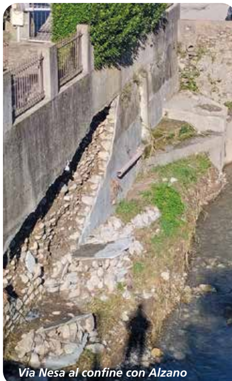
Allagamento proprietà privati
